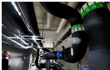
Idag leds överskottsvärmen tillbaka till Fortum Värmes anläggning för att återvinnas som värme i fjärrvärmenätet.
