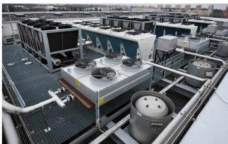
Tidigare användes fläktarna på taket för att fläktat ut överskottsvärmen från serverhallarna.
