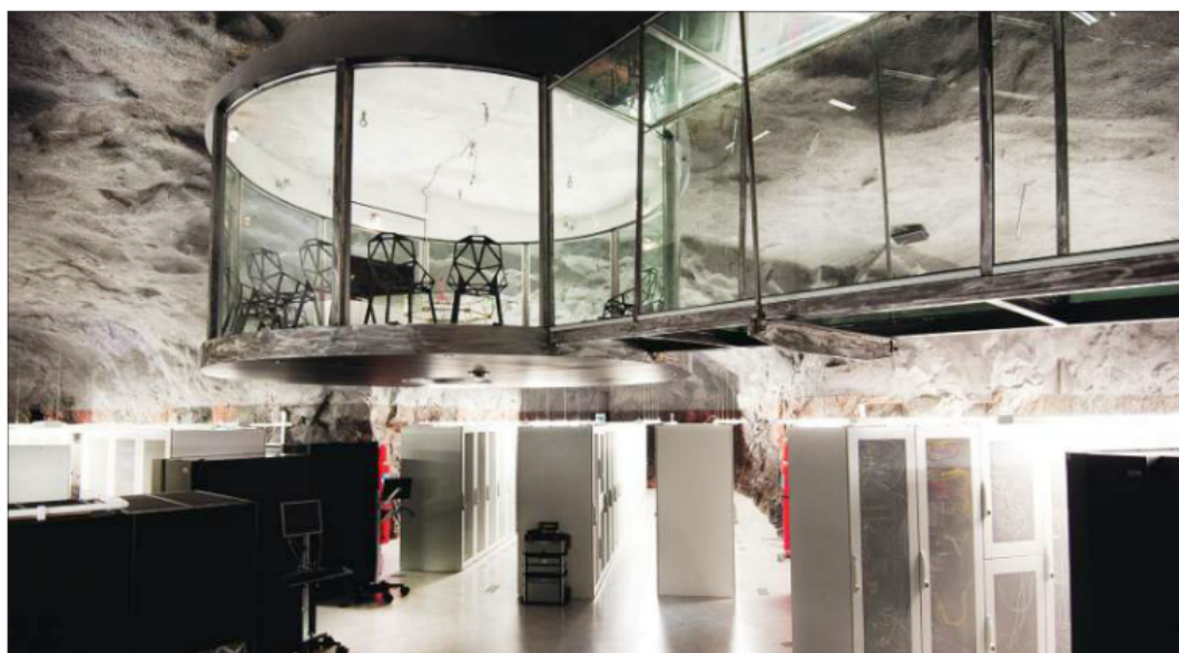
Fortum Värme använder restvärme från Bahnhof's datacenter. Nu vill energibolaget att flera datahallar ska välja Stockholm.
